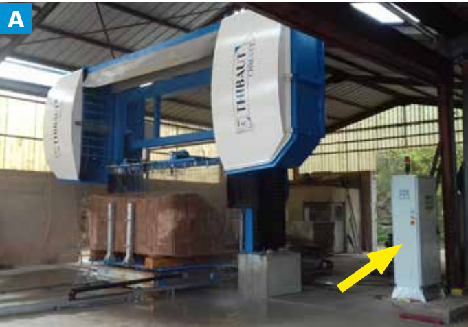
EN Control panel on electrical cabinet. FR Pupitre de contrôle sur armoire électrique. DE Bedientafel auf elektrischem Schrank. ES Panel de control sobre armario eléctrico.
